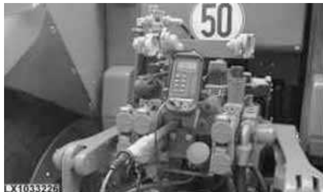
Έλεγχος της πίεσης αναμονής του υδραυλικού συστήματος
